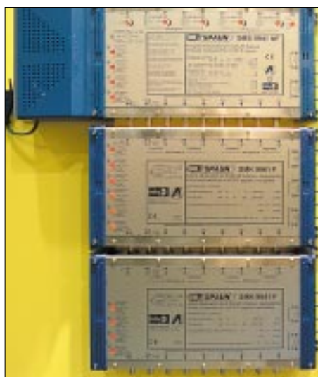
Bild 1: Kaskadierbares, DiSEqC-fähiges Multischaltersystem SMK 99xx von Spaun zur Verteilung von acht Satellitenebenen zuzüglich terrestrischem TV/UKW-Signal
